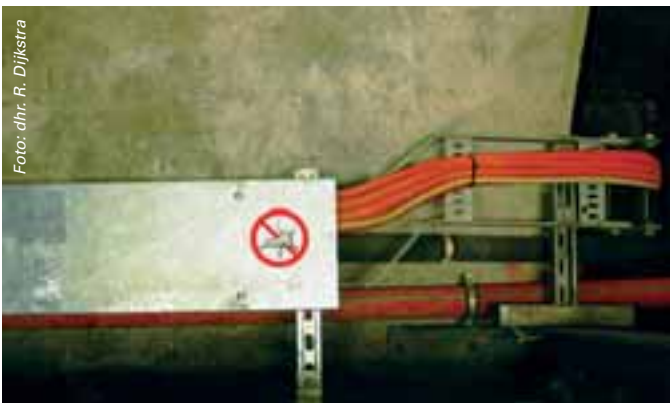
De kabelladders werden volgens een zogenoemde losse hangconstructie aan het looppad gehangen. Het grote gewicht van het tracé zorgt voor een enorme neerwaartse druk, waardoor het met het 'losse' karakter van de constructie nogal meevalt.
